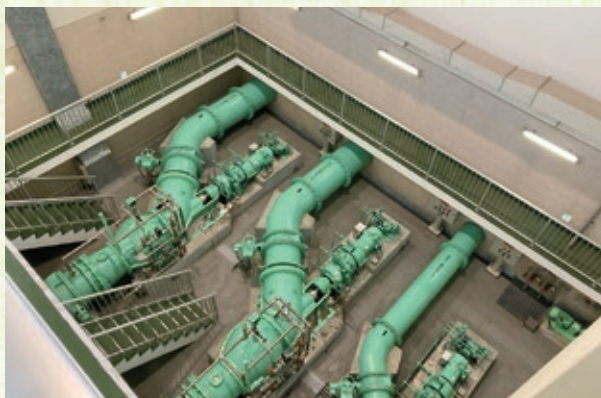
< 金野井揚水機場のポンプ >
