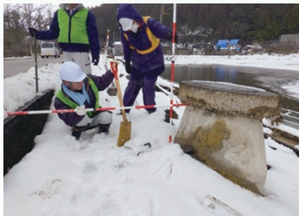
< 被災した管路施設の状況調査 >
