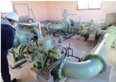
< 米納津佐渡山地区第2揚水機場の パイプライン >
