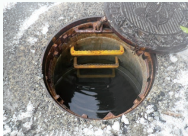
< 管路施設の破損により施設内の汚水が排水できない状況 >
